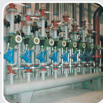
Гідравлічна теплорозподільна установка.
