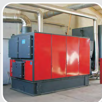
Ardere in boiler cu biomasa.
