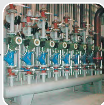
Instalatie hidraulica pentru incalzirea fluidului.
